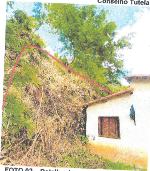
FOTO 02 – Detalhe do escorregamento que provocou o soterramento do imóvel do Conselho Tutelar
