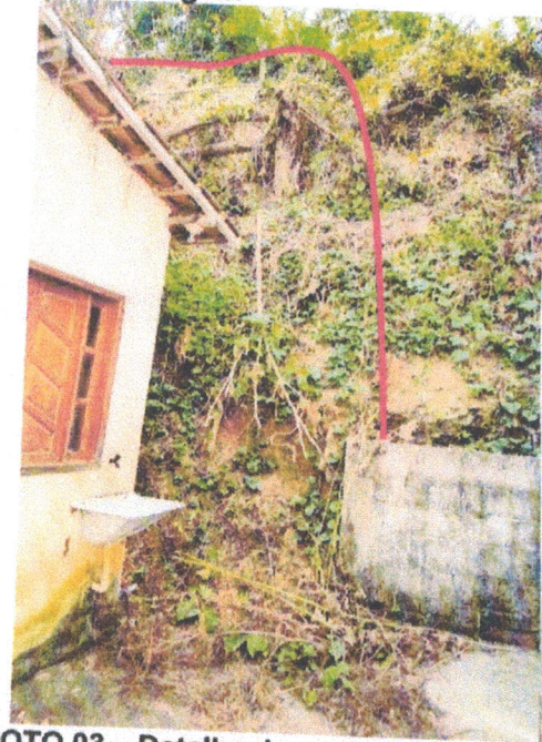
FOTO 03 – Detalhe do escorregamento que provocou o soterramento do imóvel do Conselho Tutelar
