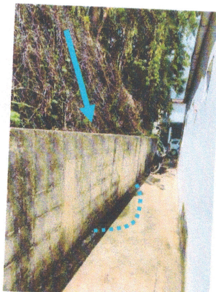
FOTO 07 – Surgimento de água na base da encosta e fundos da Casa de Passagem
