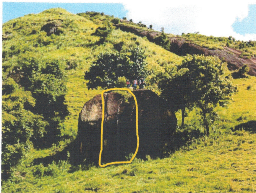
FOTO 14 (DRONE) – Vista frontal do bloco vistoriado onde se visualiza fraturas (polígono amarelo) e equipe de vistoria na crista do mesmo.
