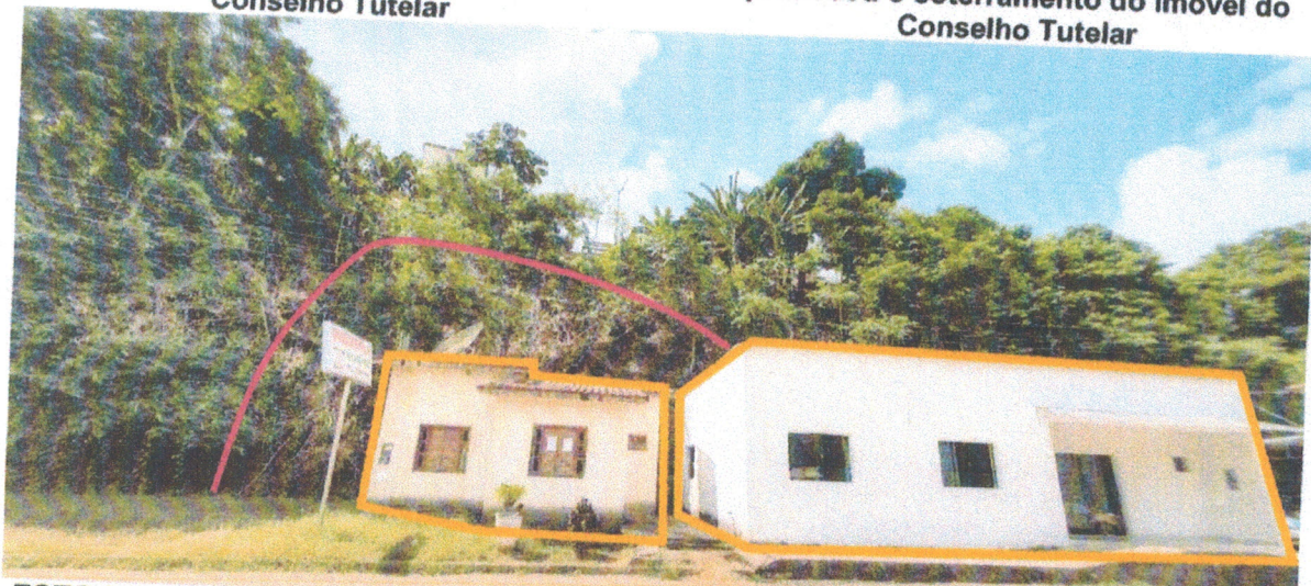
FOTO 04 – Vista geral da encosta com escorregamento e os imóveis do Conselho Tutelar e Casa de Passagem
